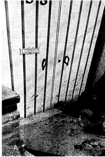
Imagen 6. Imagen donde se observa como la puerta del domicilio de la que suscribe, fue manchada de cemento. Y la obstrucción del acceso para transitar. (08/02/2022)
