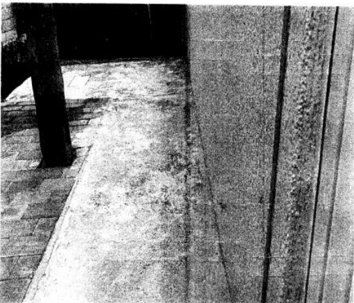
Imagen 9: Imagen del antes, de cómo se encontraba la banqueta y la fachada del domicilio de quien suscribe. (2021)
